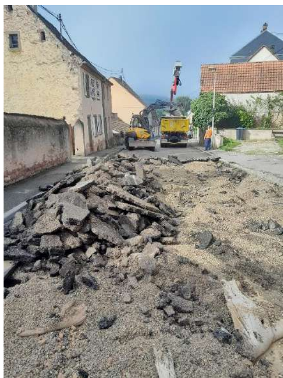
Rue de Cosswiller suite à la rupture du 07/09/2024
